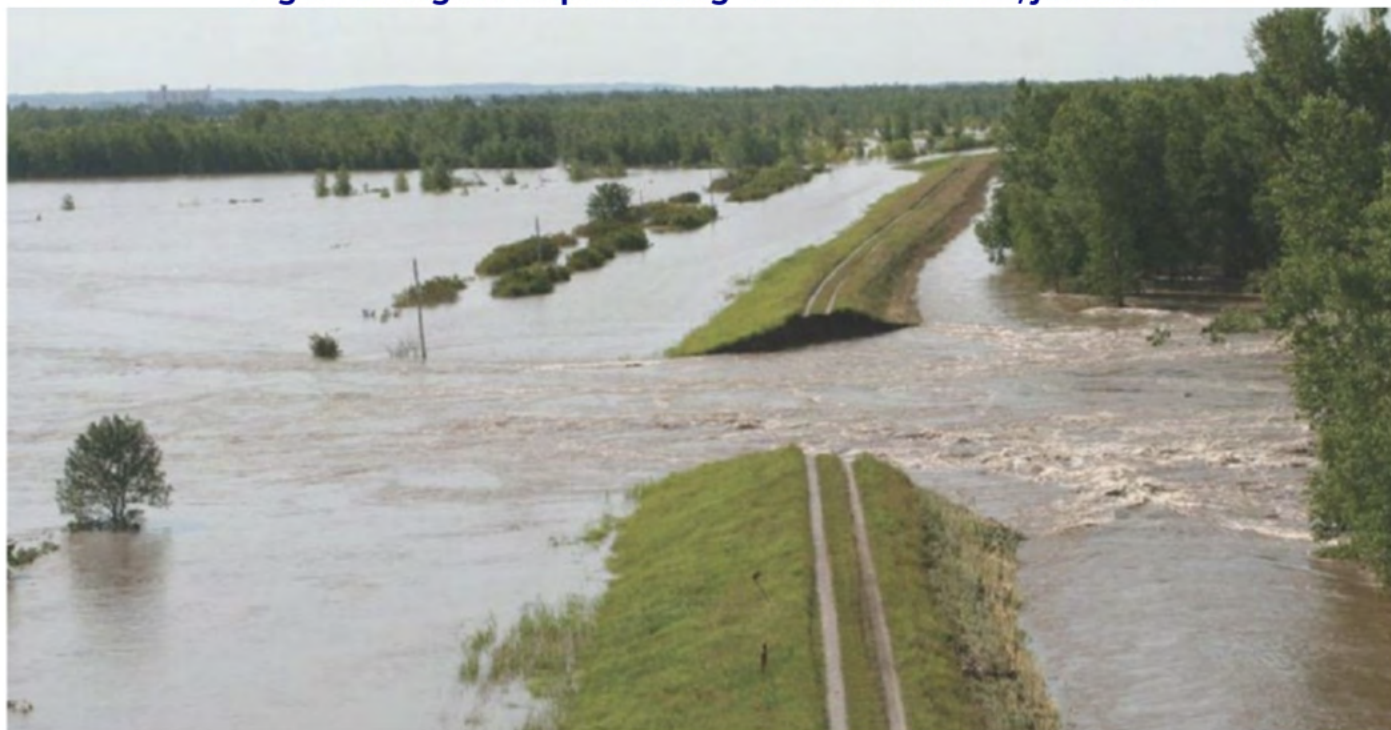
Figure 2 : Digue rompue le long du fleuve Missouri, juin 2011
