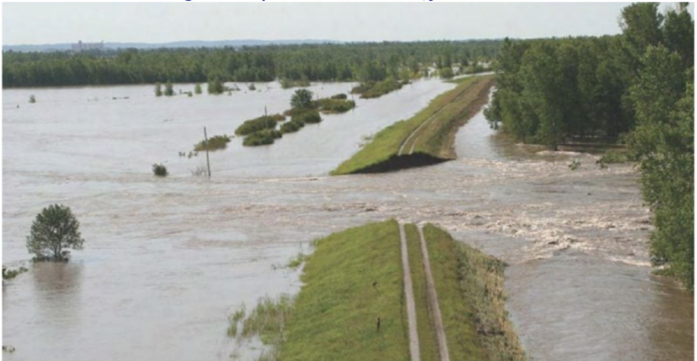
Figura 2: Dique roto del río Misuri, junio de 2011
